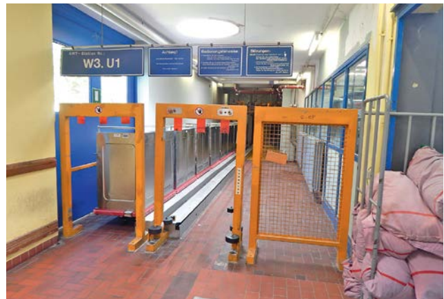
Die automatische Warentransportanlage (AWT) in der Zentralwäscherei des Universitätsklinikums Düsseldorf.
